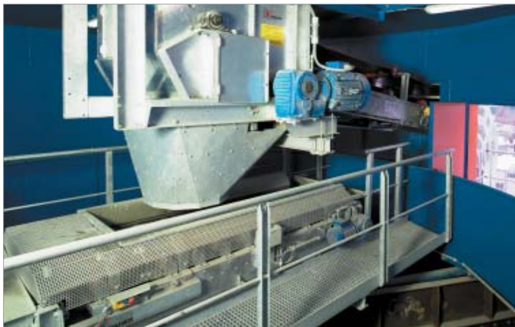
Fig. 2: Cinta de distribución sobre el silo de varias cámaras
