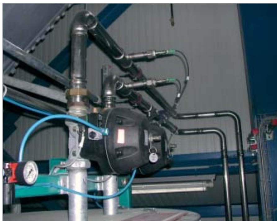
Fig. 8: La báscula de agua con las dos conducciones de llenado (todavía sin el aislamiento térmico)
