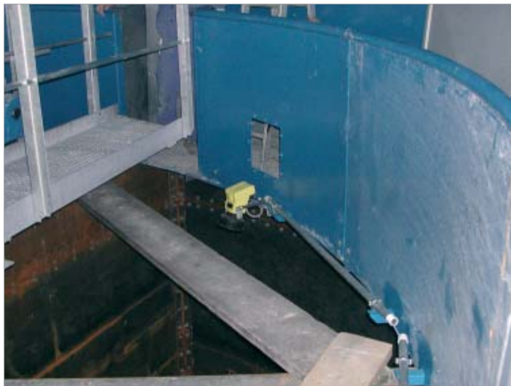
Fig. 3: Medidor de ultrasonidos para el nivel de carga del silo de varias cámaras
