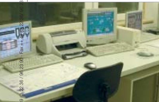
Puesto de control con las estaciones centrales de manejo y supervisión
