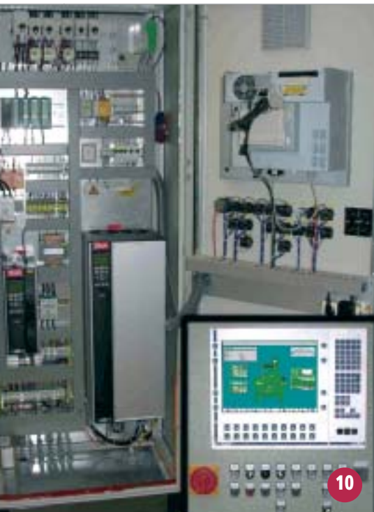
El armario de distribución con el PC industrial integrado en la puerta
